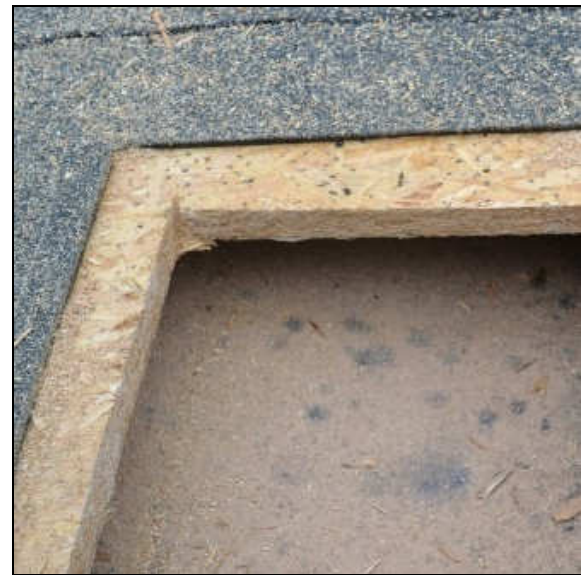
Abb. 31: Schimmelpilzbildungen auf der Unterseite der Dachscha- lung in belüfteter Dachkonstruktion
