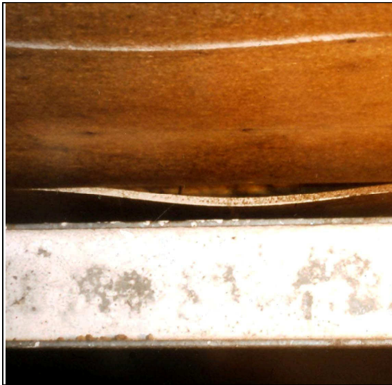
Abb. 11: Durch Feuchtigkeitseinwirkung verformte Spanplatten
