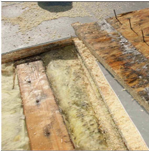
Abb. 30: Schimmelpilzbildungen auf der Unterseite der Dachscha- lung in unbelüfteter Dachkonstruktion
