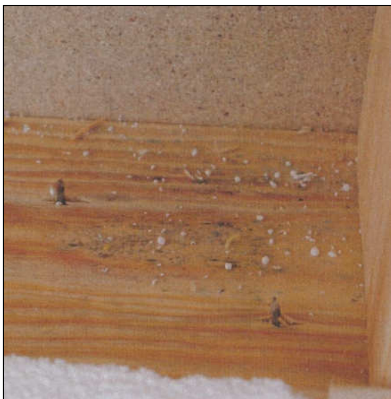
Abb. 28: Schimmelbewuchs auf den tragenden Hölzern der Außenwände
