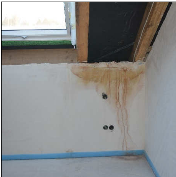
Abb. 48: Wasserlaufspuren im Bereich des Drempels
