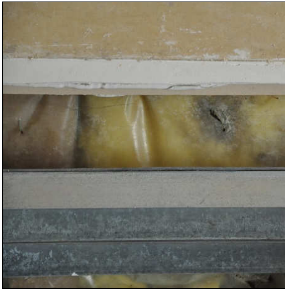
Abb. 38: Durch Trockenbauarbeiten beschädigte Luftdichtheitsebene
