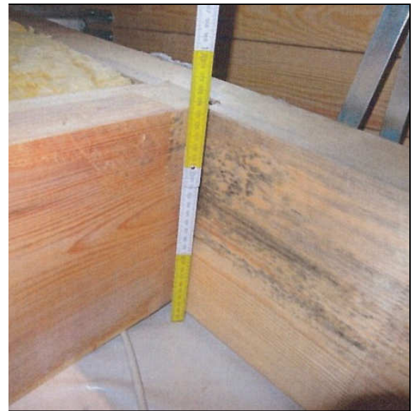
Abb. 57: Detailansicht eines befallenen Holzbalkens
