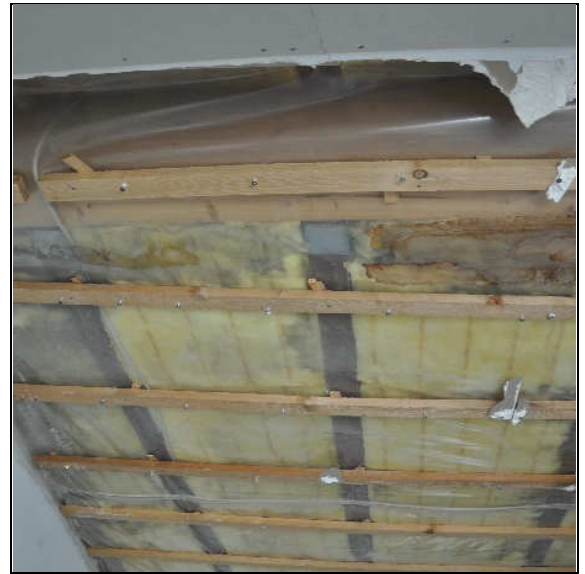
Abb. 39: Schimmelbildung in der Mineralwollendämmung wurde durch Lücken in der Luftdichtheitsebene verursacht
