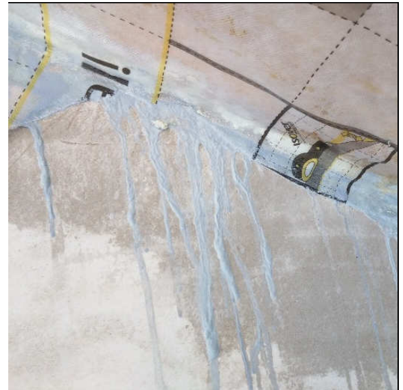
Abb. 47: „Verwässerte“ Klebeschnur der Luftdichtheitschicht
