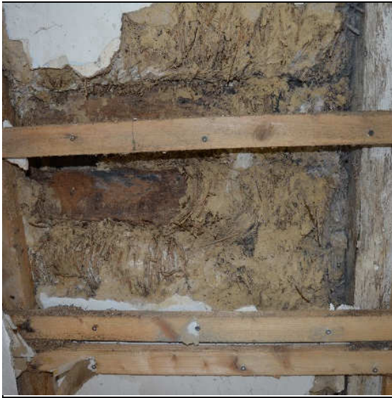
Abb. 18: Schimmelbefall im Deckenpaket
