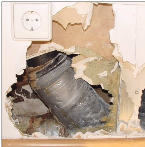
Abb. 23: Offene Muffe der WC-Abflussleitung
