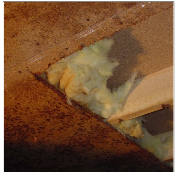
Abb. 10: Der Fußbodenaufbau besteht aus Holzträgern mit dazwischenliegender Wärmedämmung sowie jeweils einer unteren und oberen Spanplatte. Die Unterseite der unteren Bekleidung ist von Schimmelpilzen befallen.
