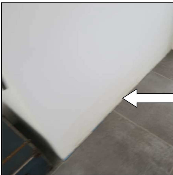
Abb. 13: Wasserkränze am Wandsockel
