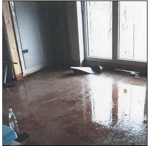
Abb. 25: Starker Wassereintrich nach der Montage des Erdgeschosses
