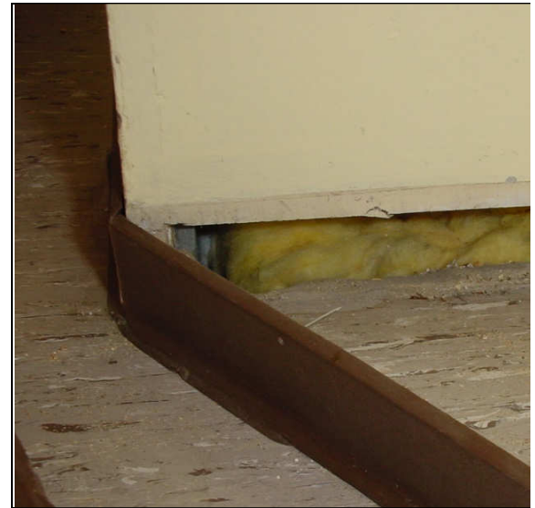
Abb. 12: Auf der oberen Spanplatte ist nur ein Belag aufgeklebt. Wirksame luftdichtende Maßnahmen, die den Hohlraum unter der Schule von den Innenräumen der Klassenzimmer zuverlässig trennen, sind nicht vorhanden.
