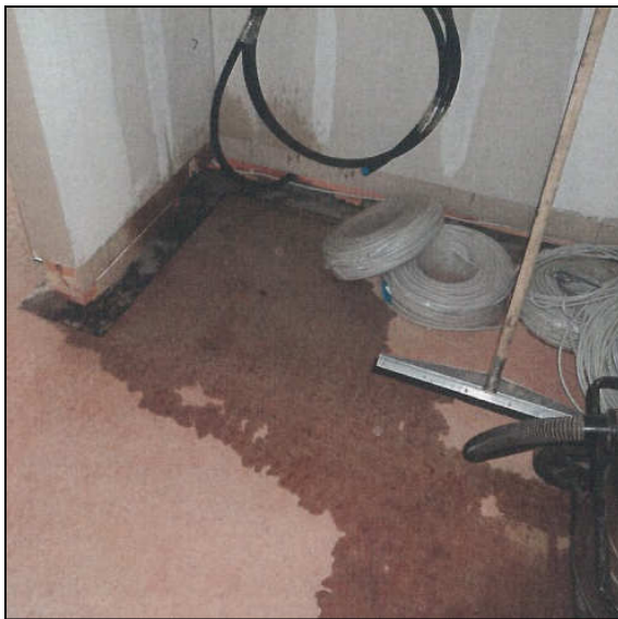
Abb. 26: In die Wand „aufsteigende“ Feuchtigkeit im Erdgeschoss
