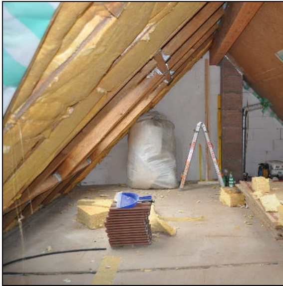
Abb. 42: Teilweise, aber nicht vollständiger Austausch der Dämmung nach Instandsetzung der Wasserschadensursache
