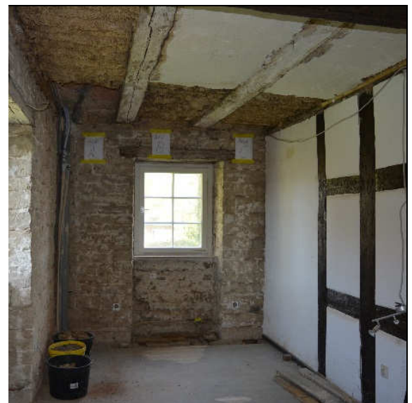
Abb. 17: Unterseite der durchfeuchteten Decke
