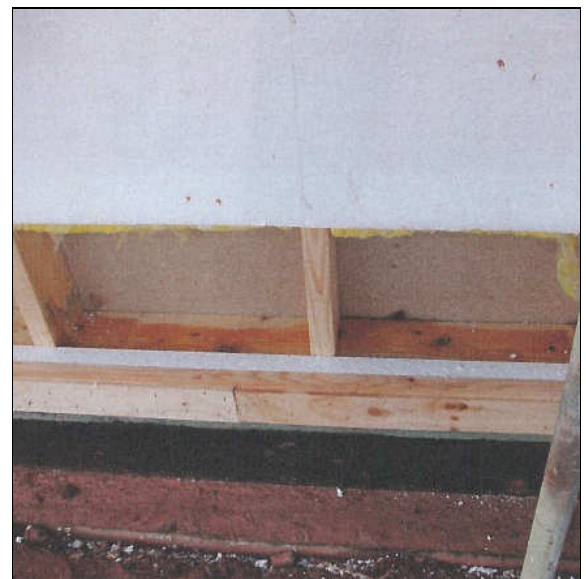
Abb. 29: Durchfeuchtung des Schwellenholzes
