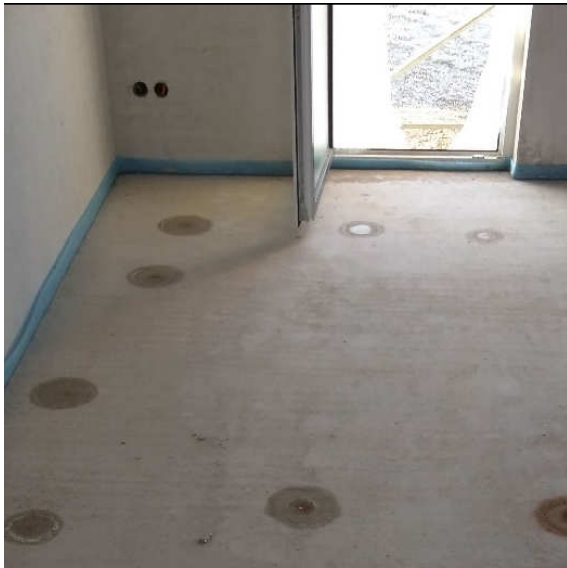
Abb. 46: Tropfstellen auf der Oberseite des Estrichs
