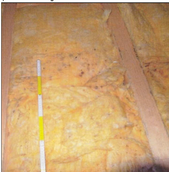
Abb. 58: Schimmelscheinungen auch auf der Oberseite der Mine- ralwolle im Bereich einer ehemaligen Abdeckung
