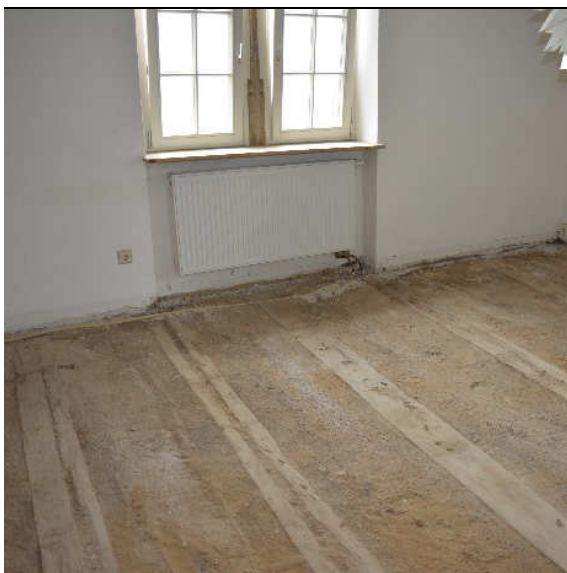
Abb. 16: Blick auf den geöffneten Fußboden und den schadensauslösenden Heizkörper im 1. OG
