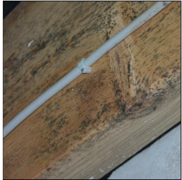
Abb. 51: Detailansicht eines befallenen Sparrens
