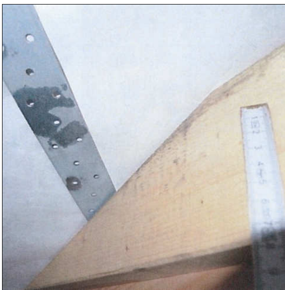
Abb. 54: Schimmelbewuchs auf der Oberfläche der Dachsparren, Weißrostbildung auf dem Windrispenband
