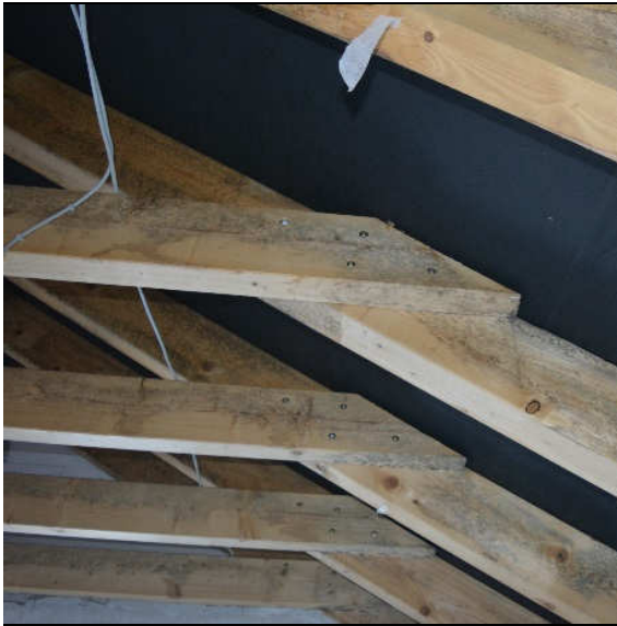
Abb. 50: Innenansicht des verschimmelten Dachstuhls nach dem Entfernen der Mineralwolle-Dämmung
