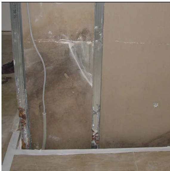
Abb. 22: Von Schimmel befallener Innenraum der Gipskartonwand
