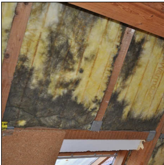
Abb. 40: Wasserschäden verursachten starken Schimmelbefall im Bereich der Dachflächenfenster
