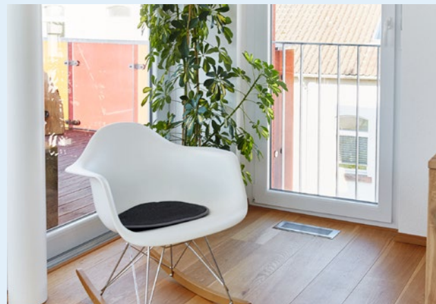
Abbildung 10: Zuluftauslass im Wohnzimmer
